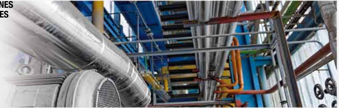
INSTALACIONES HIDROSANITARIAS DE CALEFACCIÓN Y CLIMATIZACIÓN
