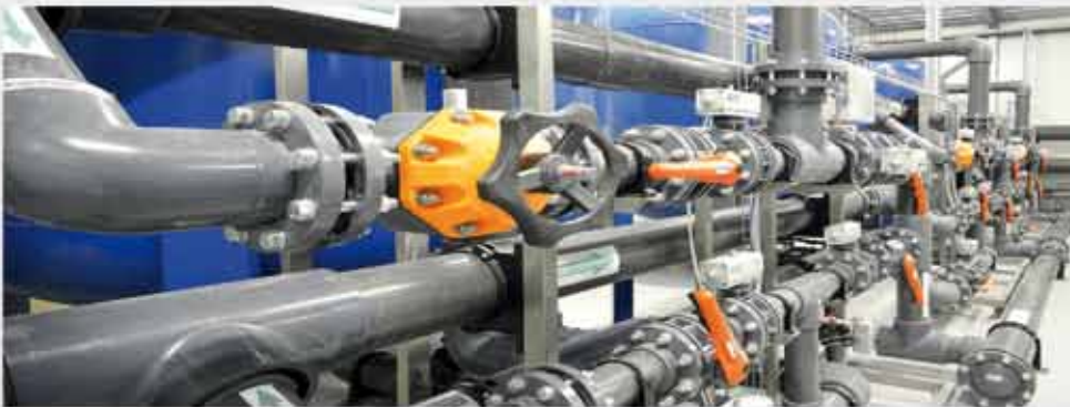
INSTALACIONES ENERGÍA SOLAR ALTA TEMPERATURA
