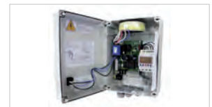
12 Cuadro eléctrico para motor tubular cubierta sumergida
