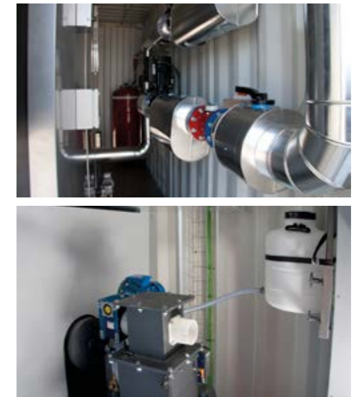
Detalles instalación hidráulica e interior
