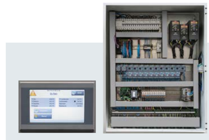
Cuadro y display de control con PLC
