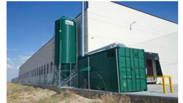
Instalación en secadero de jamones
