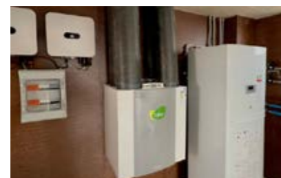
Sistema de Ventilación de la vivienda
