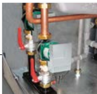
Bombas y cierres metálicos de interceptación
