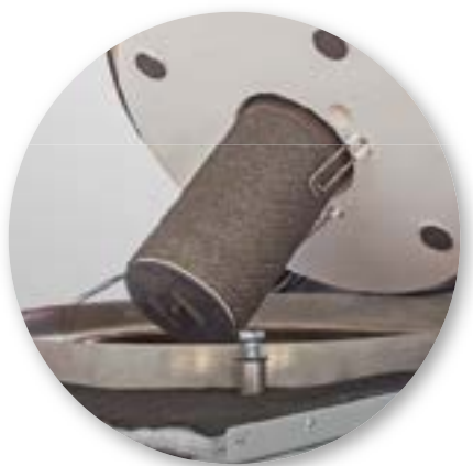
CÁMARA DE COMBUSTIÓN DEL QUEMADOR
