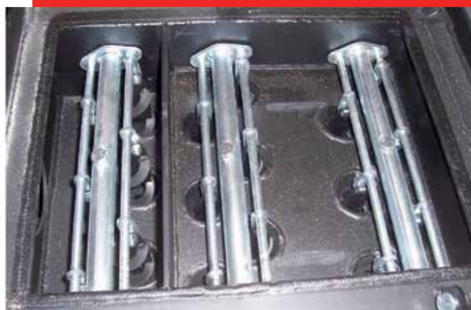
LIMPIEZA TURBULADORES POR PALANCA MANUAL
