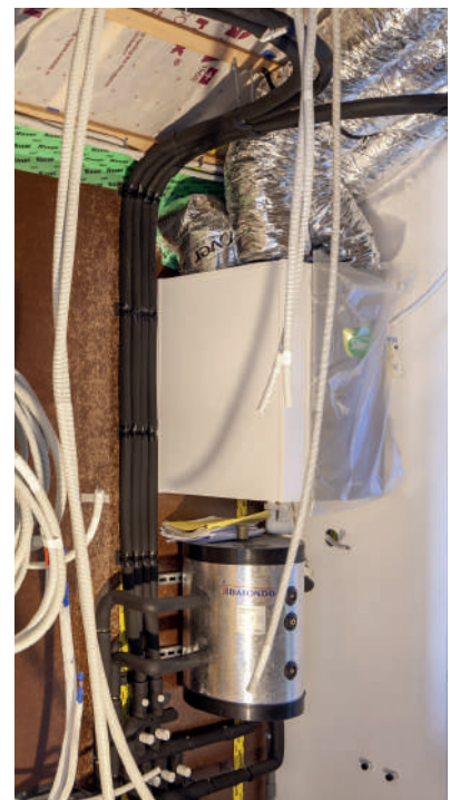
Sistema de Ventilación de la vivienda
