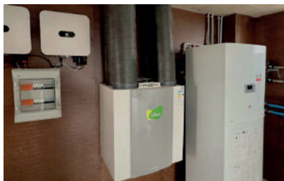
Sistema de Ventilación de la vivienda
