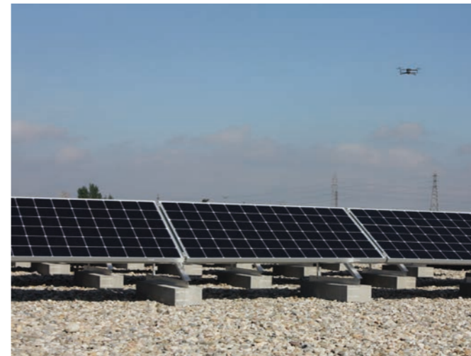
Imagen cedida por Instal-lacions Jorfe
