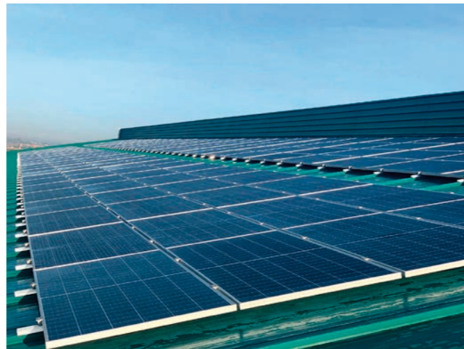
Imagen cedida por Instal-lacions Jorfe
