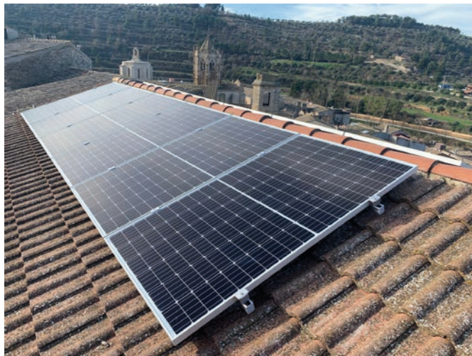
Imagen cedida por Instal-lacions Jorfe
