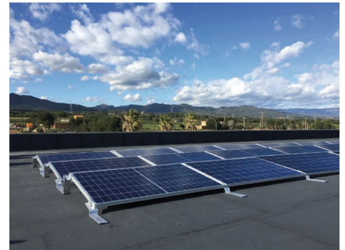
Imagen cedida por Instal-lacions Jorfe
