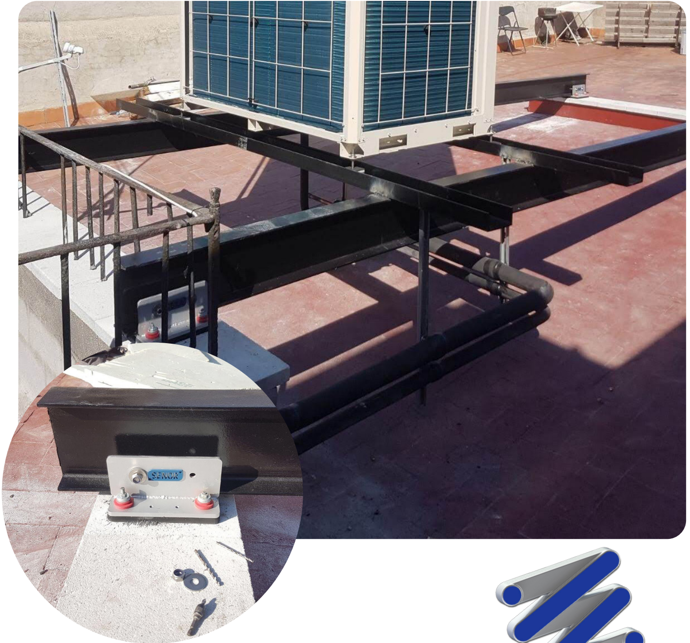
BANCADA AIR / ACÚSTICA
