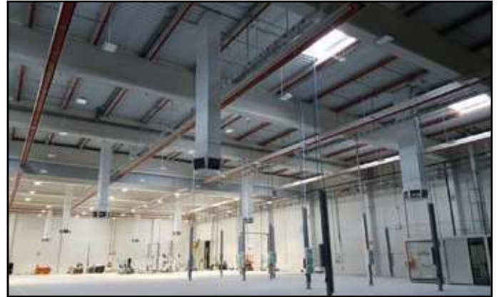
Vista interior de las Instalaciones de Pikolin
