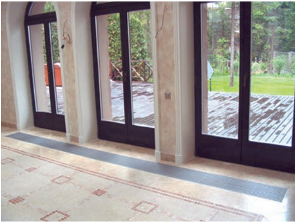
Foto 7.5. Radiador Jaga empotrado en suelo.
