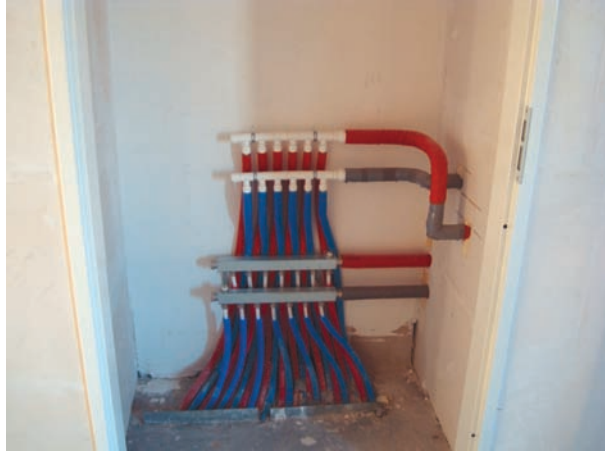
Foto 7.2. Instalación por colectores.
