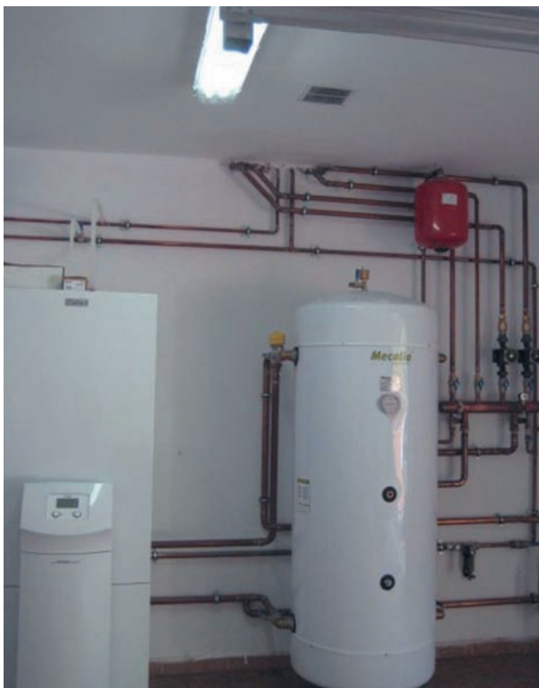
Foto 7.6. Depósito de inercia.
