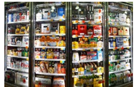
Almacenes de refrigeración
