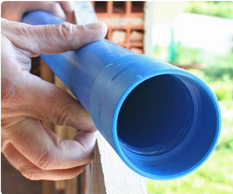
< Cordón de adhesivo que puede ocasionar problemas posteriores en la instalación
